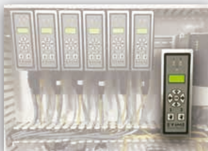
Montage sur panneau VD2
